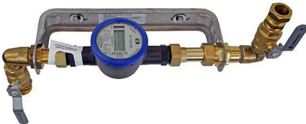
Exempel på fjärrrävlat vattenmätare och konsol med avstängningsventiler
